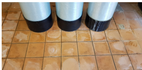
Nye trykfiltre og vandværkets rentvandstank.
