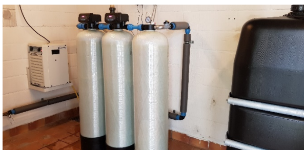
Nye trykfiltre og vandværkets rentvandstank.
